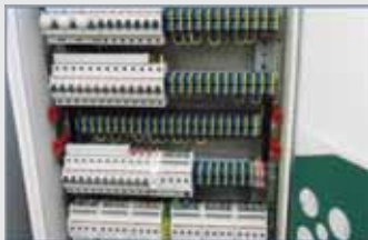
Щиты управления на базе KNX
