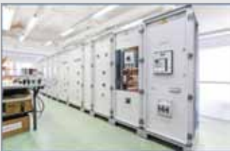
Главные распределительные щиты (ГРЩ)
