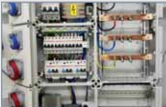
НКУ индивидуального изготовления по требованиям Заказчика
