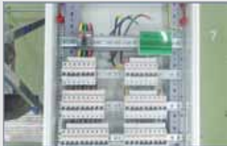
Щиты распределительные (ЩР)
